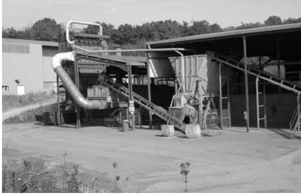
Photo 4. Vue de la section de concassage de l'usine de Léguillac-de-Cercles (cliché Gérard Sustrac).
